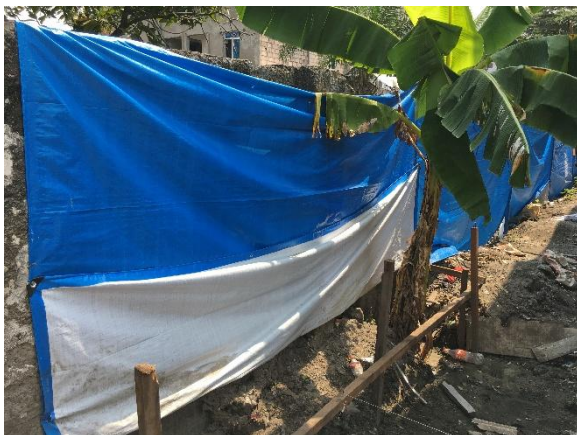
Notdürftig befestigt: Die Außenmauer wurde beschädigt
